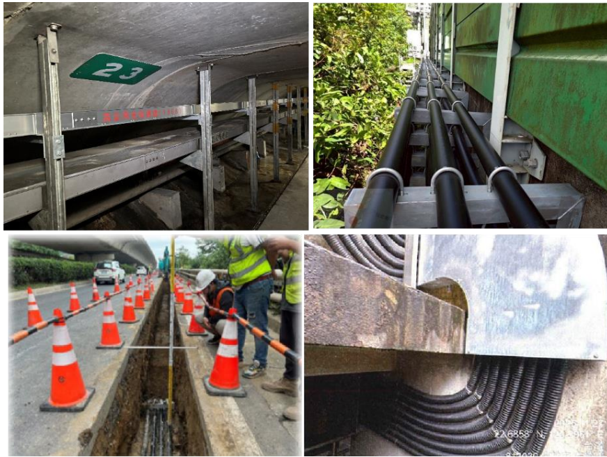
圖 41 光纜通道建設現場
