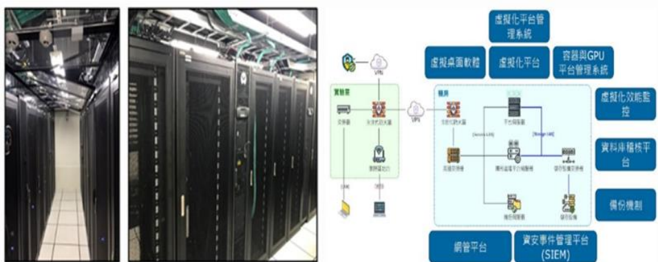
圖12 國家級軟體安全實驗室基礎設施
